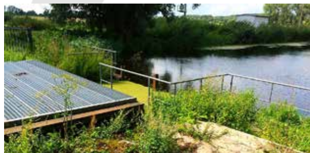
Schöpfwerk bei Zachow
